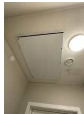
Ventilasjonsanlegg i himling i entre
