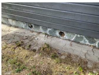
Lufting For kryperom
