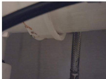
Lekasje kan sees under avløpsrøret.
