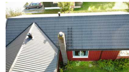
Det er montert takstige opp til pipe med takbro
