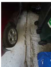
Slitt og ujevnt betonggulv i garasje
