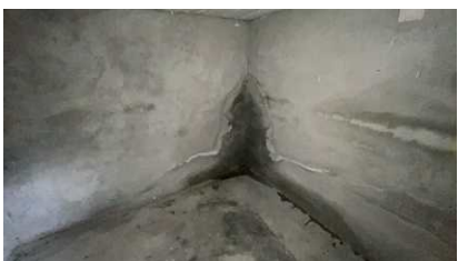
Synlig fukt i lagerrom 4
