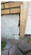
Sprek i grunnmur ved garasjeport
