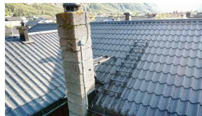
Pipe mangler tilstrekkelig toppavdekning.
