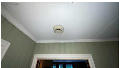
Brannmelder i gang 1. etasje virker ikke
