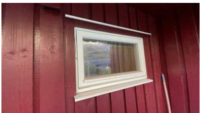
Vindu på bad fra 2011
