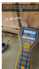
Kontroll av innforet yttervegg i lagerrom 3. Det er målt 100% og synlig fukt med råte i panel/vegg
