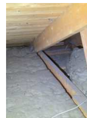
Mangler deler av isolasjon og det er begrenset med ventilering ut mot raftekasse enkelte steder
