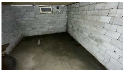
Synlig fukt i gulv lagerrom 2
