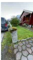
Skjev portstolpe på en side av innkjørsel
