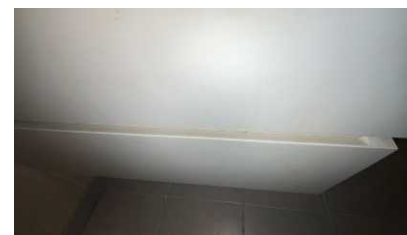
Liten skade på nedre del av skuffe på servantskap
