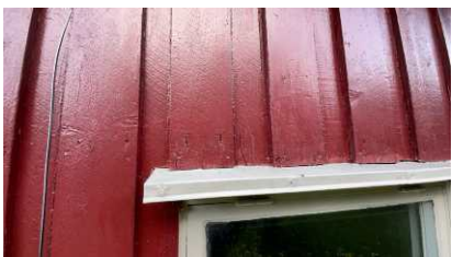
Kledning er ført helt ned til beslag enkelte steder over vindu noe som bidrar til at kledning trekker fukt ved vannbelastning
