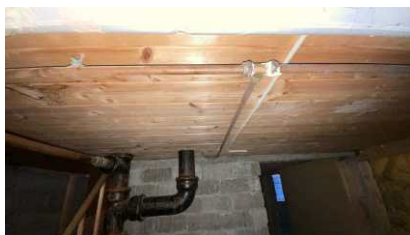
Irr på rørbømlinger som er synlig i kjeller
