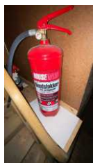
Brannslukker er ikke merket med årstall
