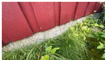
Noe løs puss/sprekk i puss under vinduet til soverom 2
