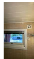
Mekanisk avtrekk på vegg og åpningsvindu
