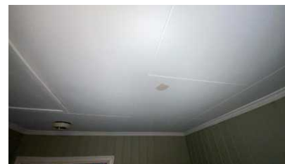
Avskalling av maling i himling gang
