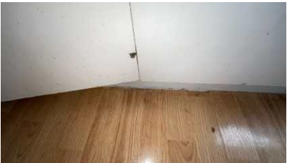
Laminatgulv er ikke lagt helt inntil sokkel på kjøkkeninnredningen.
