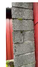
Sprekk i ytter-element på pipe
