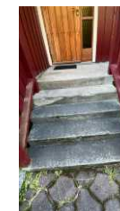
Betongtrapp har mindre sprekker/skader
