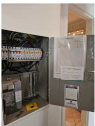
Sikringskap med automatsikringer og kursfortegnelse
