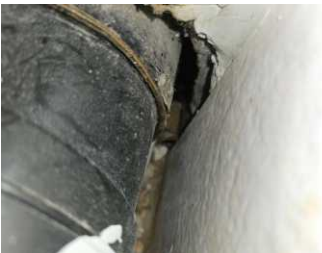
Lite fagmessig gjennomføring i våt sone
