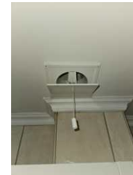
Naturlig avtrekk med ventil i himlingen på badet
