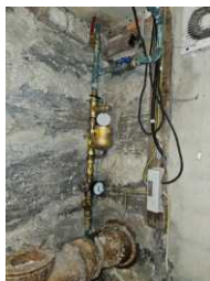
Felles stoppekran for vann, i kjelleren
