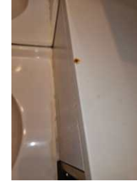
Brune merker, trolig svimerker, på servanten
