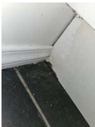
Skade på sokkelfront, trolig etter vannsøl
