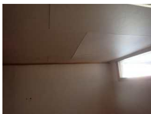
Løse takplater i kjeller
