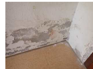
Avskallende puss/ maling
