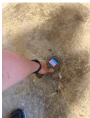
Forhøyede fuktindikasjoner på gulv.
