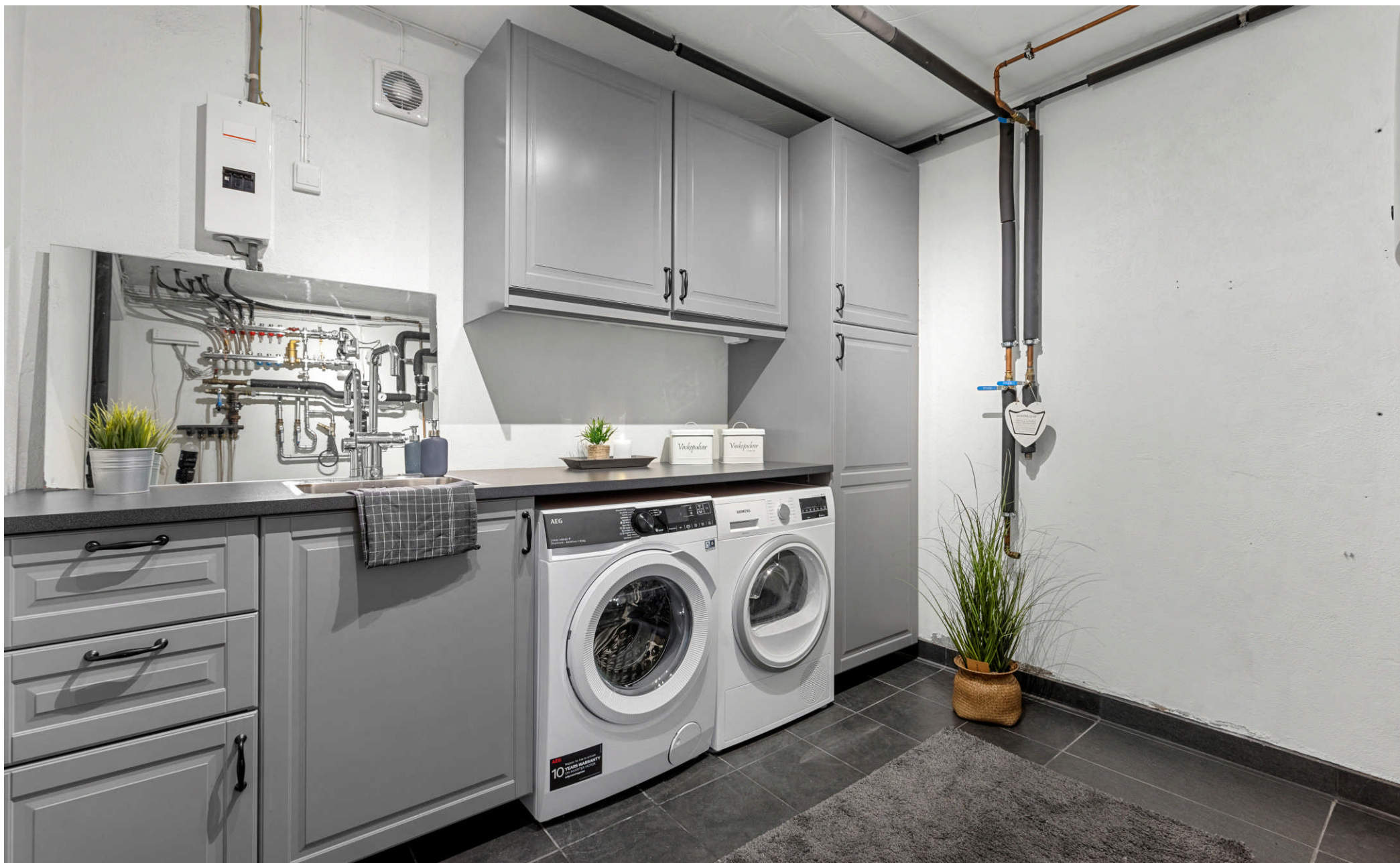
Teknisk rom i sokkel. Deler av boligen varmes opp via vann-luft varmepumpe.
