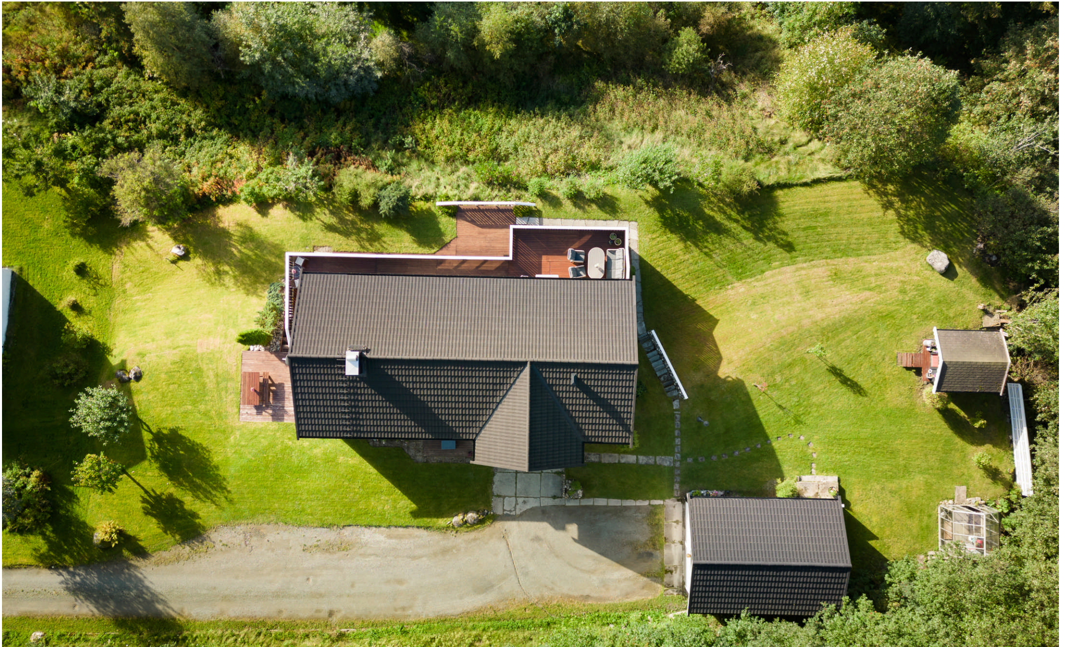
I 2018 ble det lagt nytt tak, ny pipehatt, ny takstige samt nye takrenner. Utført av K. Aune Bygg.
