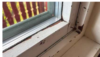
Slitasje på vinduet i soverommet lengst nordøst
