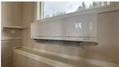
Varmepumpe i trappeoppgangen
