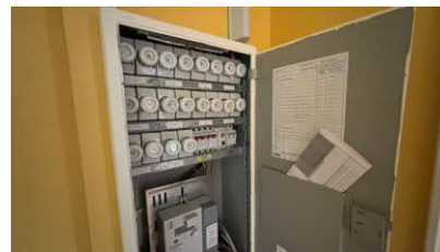
Sikringsskapet er plassert i entreen
