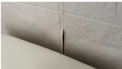
Åpninger i veggskjøter
