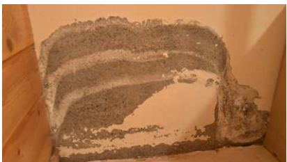
Saltutslag på flere av de åpne murkonstruksjonene
