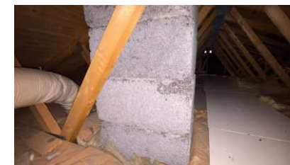
Det er en skade på et element på loftet uten at dette ser ut til å ha svekket funksjonen
