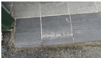
Skader i en flis like utenfor garasjeporten
