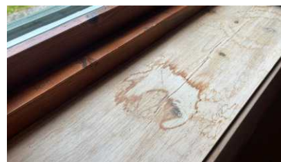
Merker som følge av vannsøl på vindusbrett i stuen i 1. etasje
