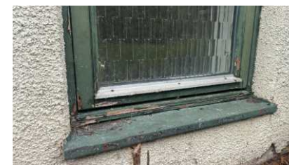
Utvendig slitasje på enkelte vinduer
