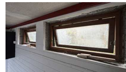
Vinduene i garasjen lar seg ikke lukke
