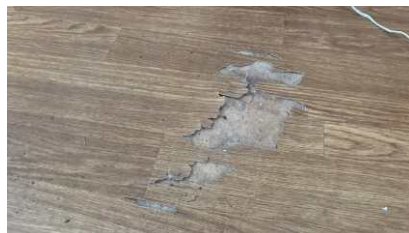
Skader i gulvet på soverommet lengst øst
