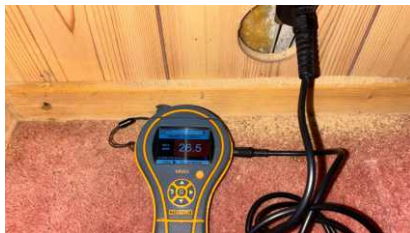
Forhøyde fuktverdier ved hulltaking
