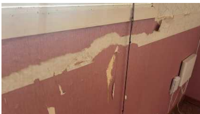
Skader på veggoverflatene på soverommet lengst øst
