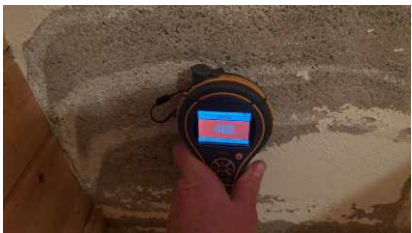
Forhøyde fuktverdier ved fuktmåling på åpne murkonstruksjoner
