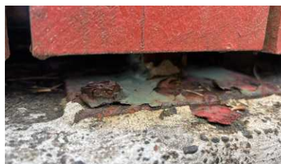
Beslaget til stolpeskoen på verandaen mot øst er med mye rust
