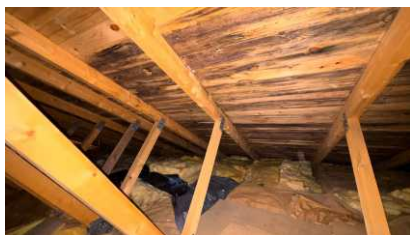
Undertaket er misfarget flere steder, spesielt på nordsiden
