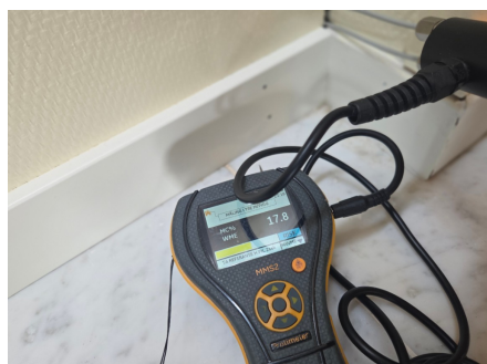
17.8% målt på yttervegg mot nord/øst kjellerstue. Dette indikerer forhøyede fuktnivåer som kan etter tid danne skader.
