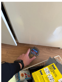
Forhøyede fuktindikasjoner på gulv fremfor kjøkkeninnredningen.
