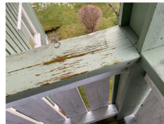
Slitte overflater på håndløper
