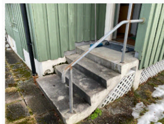
Store åpninger i rekkverk
