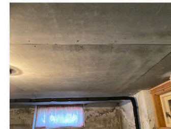
Eternittplater i innvendig tak
