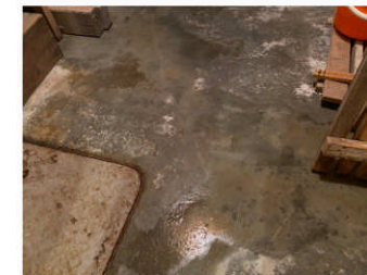
Frittstående vann på kjellergulv
