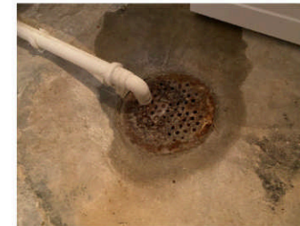
Rustent gulvsluk, gulv uten tettesjikt
