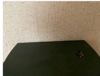
Tapet ført for nært ovn/røykløp
