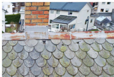
Manglende takstein, rustne mønebeslag
