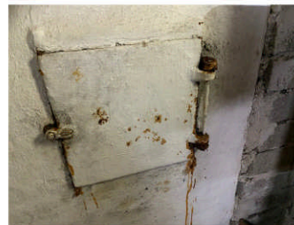
Sotluke med defekt hengsel
