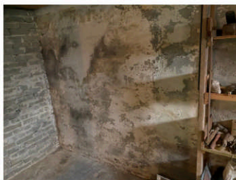
Fuktige og avflassede kjellervegger
