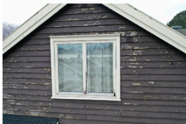
Meget malingslitt trekledning
