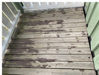
Slitte overflater på verandadekke
