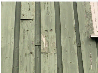
Malingslitt og endesprukket trekledning
