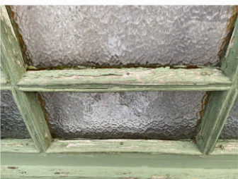
Meget slitt kjellerdør
