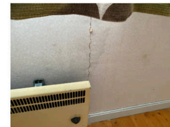
Oppsprekking av plater på vegger
