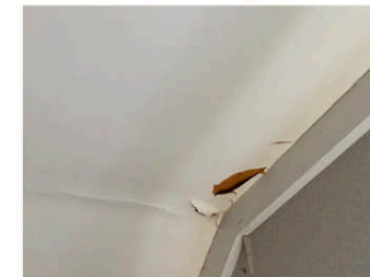
Oppsprekking av plater/maskinpapp i tak
