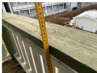
For lavt rekkverk
