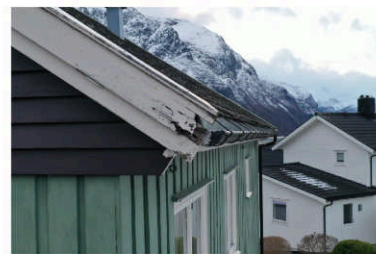
Råteskade i vindski
